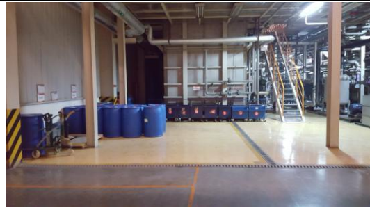
存储区泄漏收集槽
