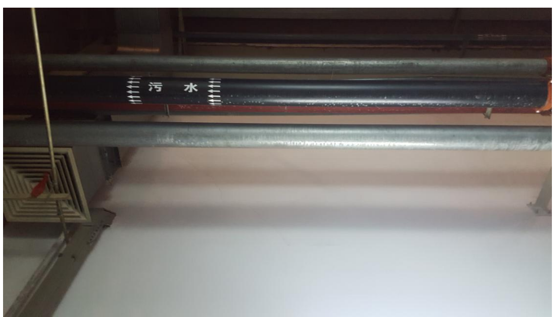
涂装车间架空污水明管
