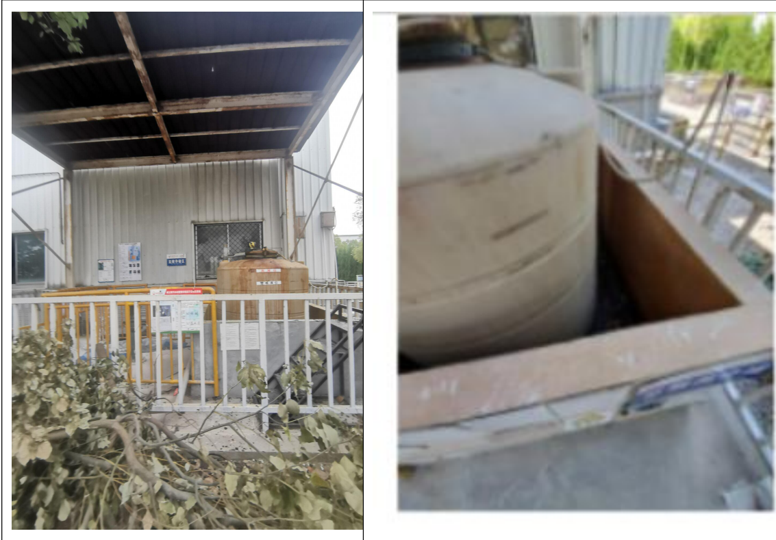
图 2-1 盐酸储存区及稀盐酸储存防护
